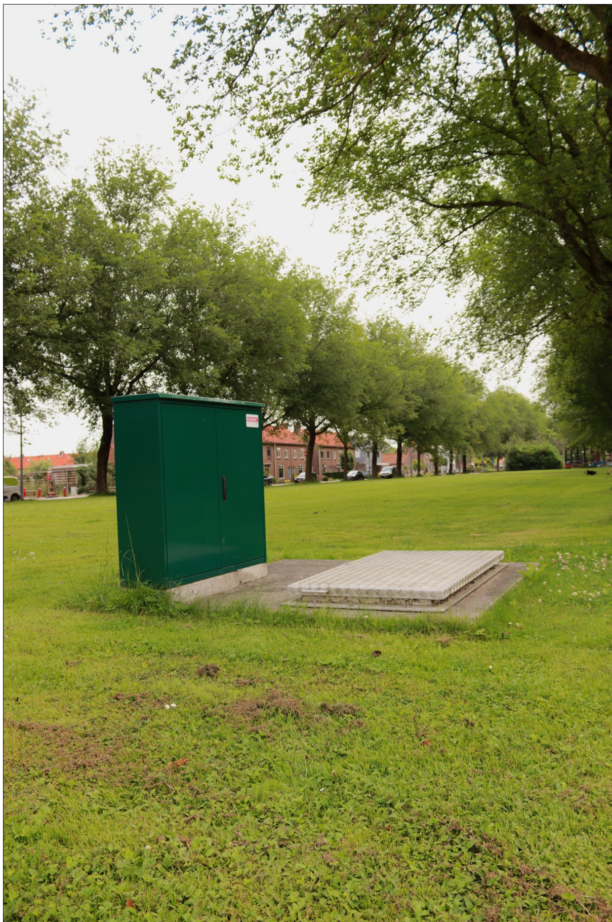
Rioolgemaal in Wieringerwerf
